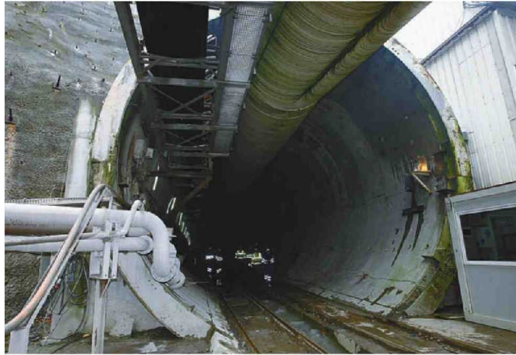
Una moderna herramienta tecnológica supondrá seguridad añadida en los túneles. RAMIRO
